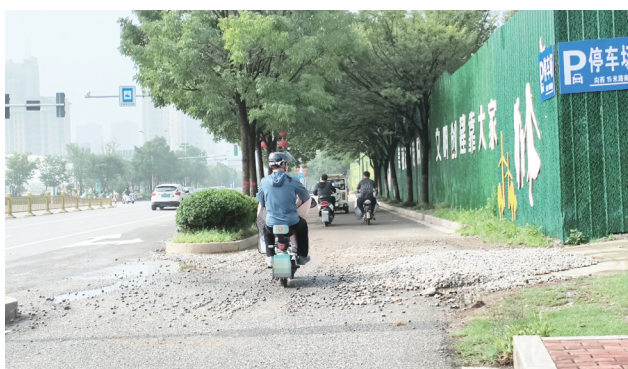
7月20日,市中区衡山路道路一侧的非机动车道处散落着石子,影响通行存隐患。(记者 杨舒 摄)
