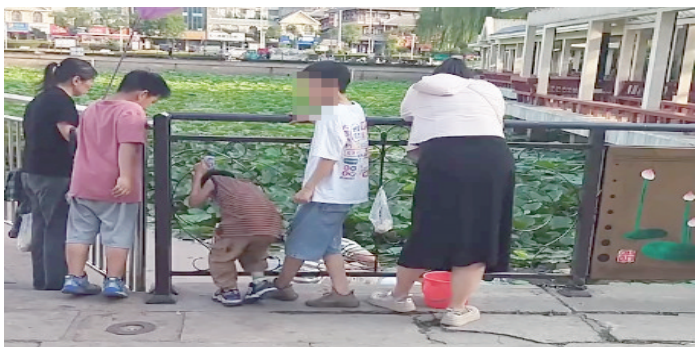
5月19日,滕州市龙泉广场荷花池护栏缺损,许多儿童围在护栏缺损处钻来钻去,存在安全隐患。( @大滕)
