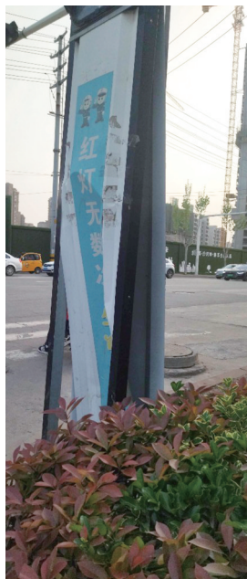
近日,市中区君山路和西沙河沿河路交会处的交通信号灯杆损坏。(记者 孔浩 摄)
