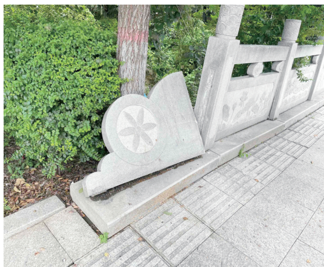
7月29日,在新城四号路的石桥上,两侧护栏均有不同程度的破损。(记者 单成镇 摄)
