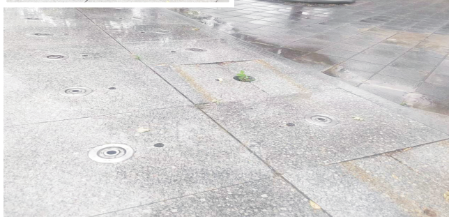
以前，下水道盖板破损断裂。
