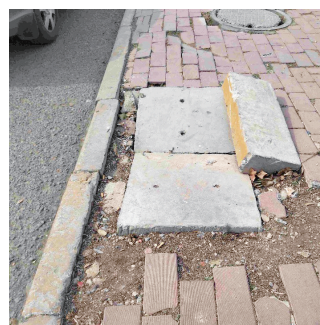
18日，在市中区鑫昌路小学西侧的人行道上，有石块挡道。
