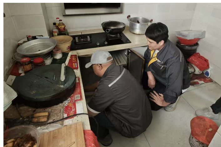
5月1日，华润燃气峰城公司第四党支部、华润燃气团支部携手仙坛苑社区居委会，共同开展“安全宣传进社区、入户安检保平安”主题活动，为居民度过一个平安、祥和的“五一”假期保驾护航。图为工作人员入户检查燃气软管老化情况。(记者 徐光 摄)
