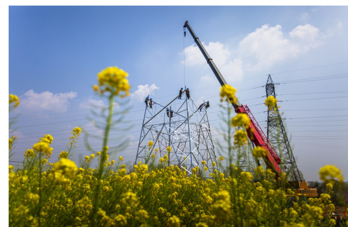
近日，在滕州市木石镇鲁南高科技工业园，国网山东枣庄供电公司工作人员正在快速推进110千伏墨润线项目建设进度。据了解，此次110千伏墨润线新建工程需新立杆塔32基，架设线路7.89公里，线路投运后将进一步提升化工园区重点企业供电可靠性，助力地方经济快速发展。图为员工正在进行17号塔组立作业。(曹欣 摄)
