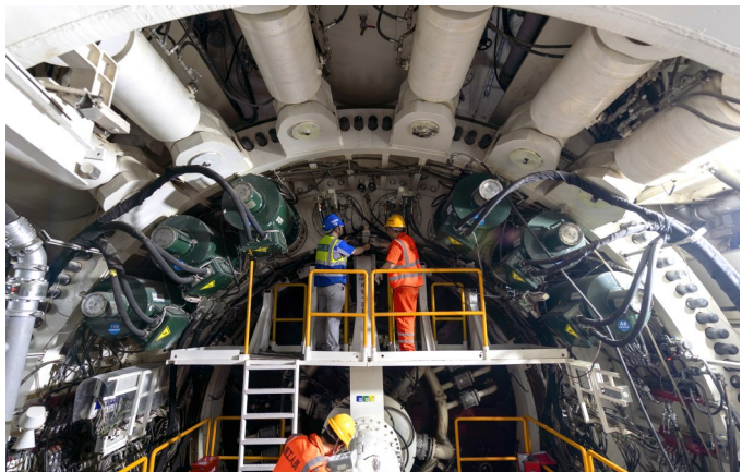
3月4日，在厦金大桥(厦门段)环岛路右线隧道项目施工现场，中铁十四局工程技术人员在对“厦金号”盾构机主驱动做日常维保。
